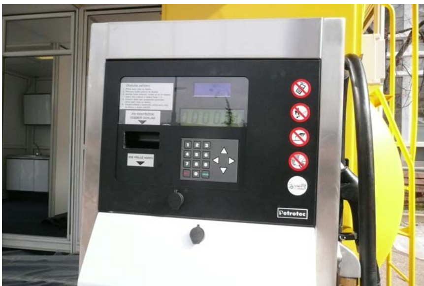
Jednotka AVP 31 integrována do výdejního stojanu PETROTEC
